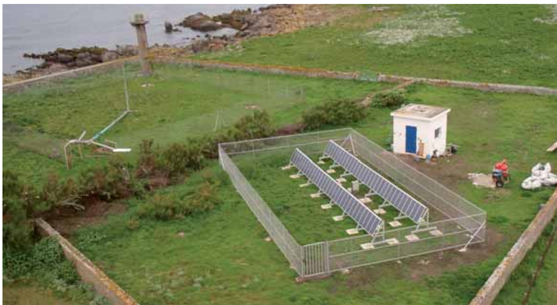
[3] Panneaux photovoltaïques et éolienne couchée sur l'île aux Moutons.
