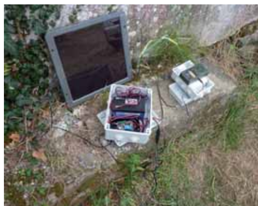
Le système de repasse sonore est protégé dans des boîtiers électriques étanches.
