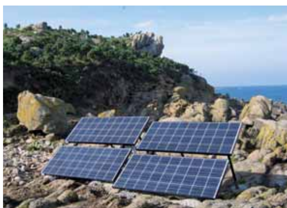
[5] Panneaux solaires alimentant la caméra.
