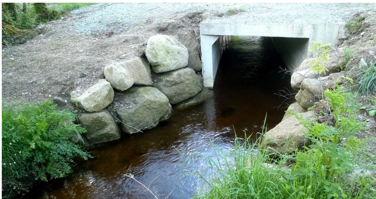
Pont cadre installé à la place d'une buse faisant obstacle à la continuité écologique, sur le Bonne Chère
