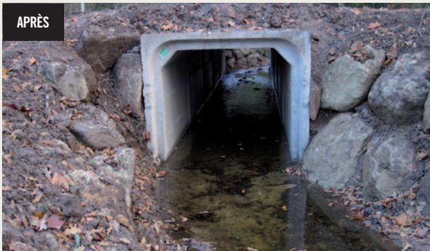
Exemple d'aménagement d'un ouvrage qui limitait la circulation des poissons et des sédiments par la pose d'un pont cadre.
